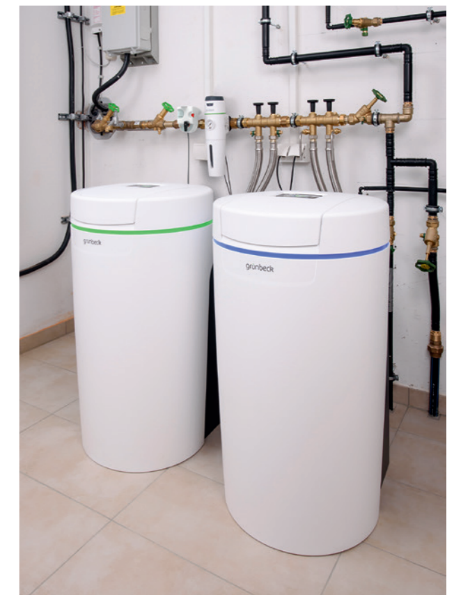
Einbausituation der Grünbeck-Anlagen
